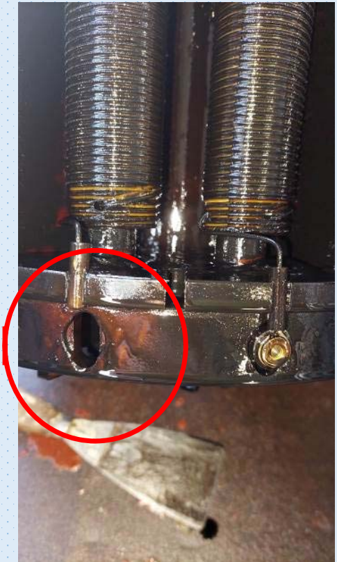
Elégett ellenállás csatlakozó
