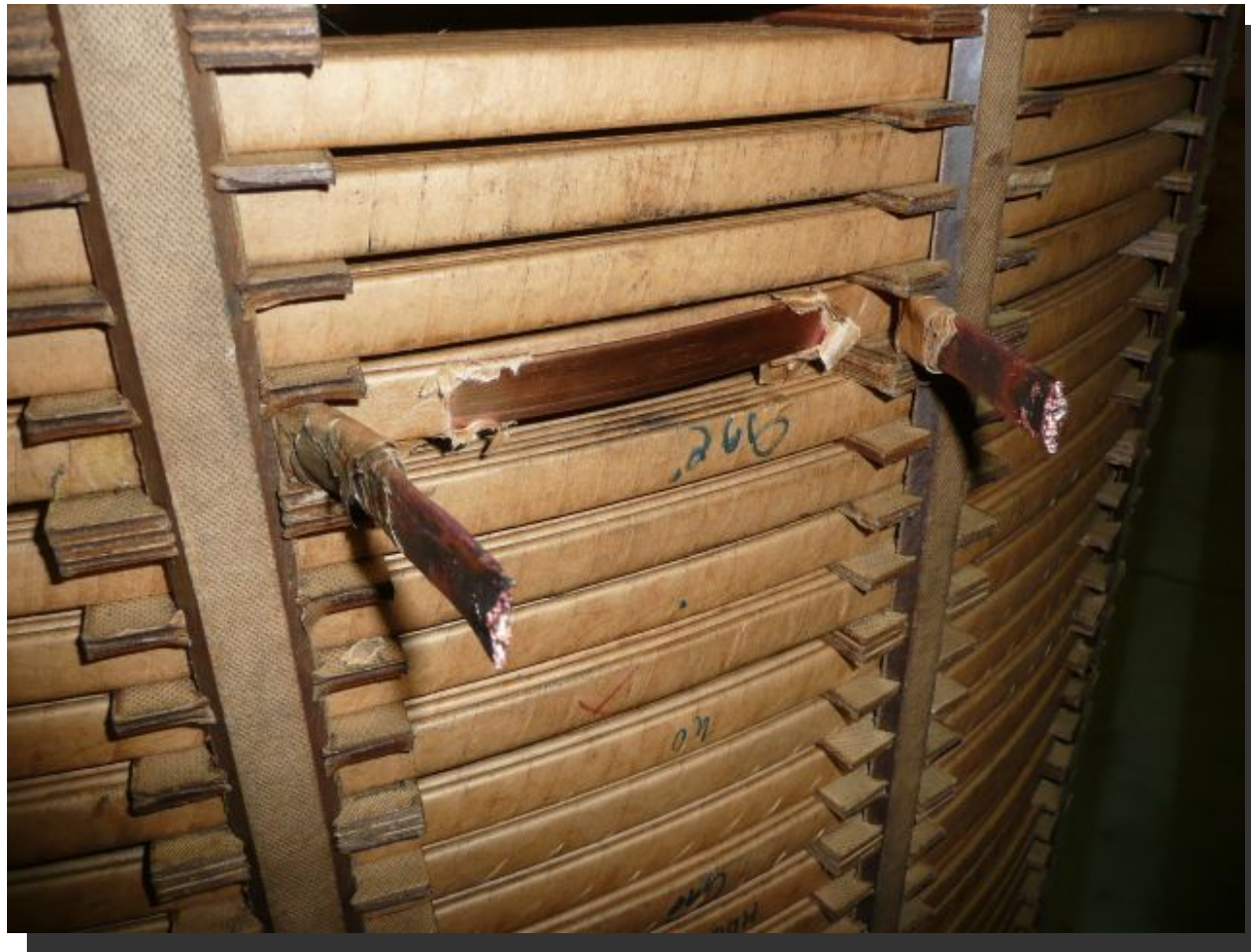
Paralel szál szakadás a 120 kV-os tekercsben
