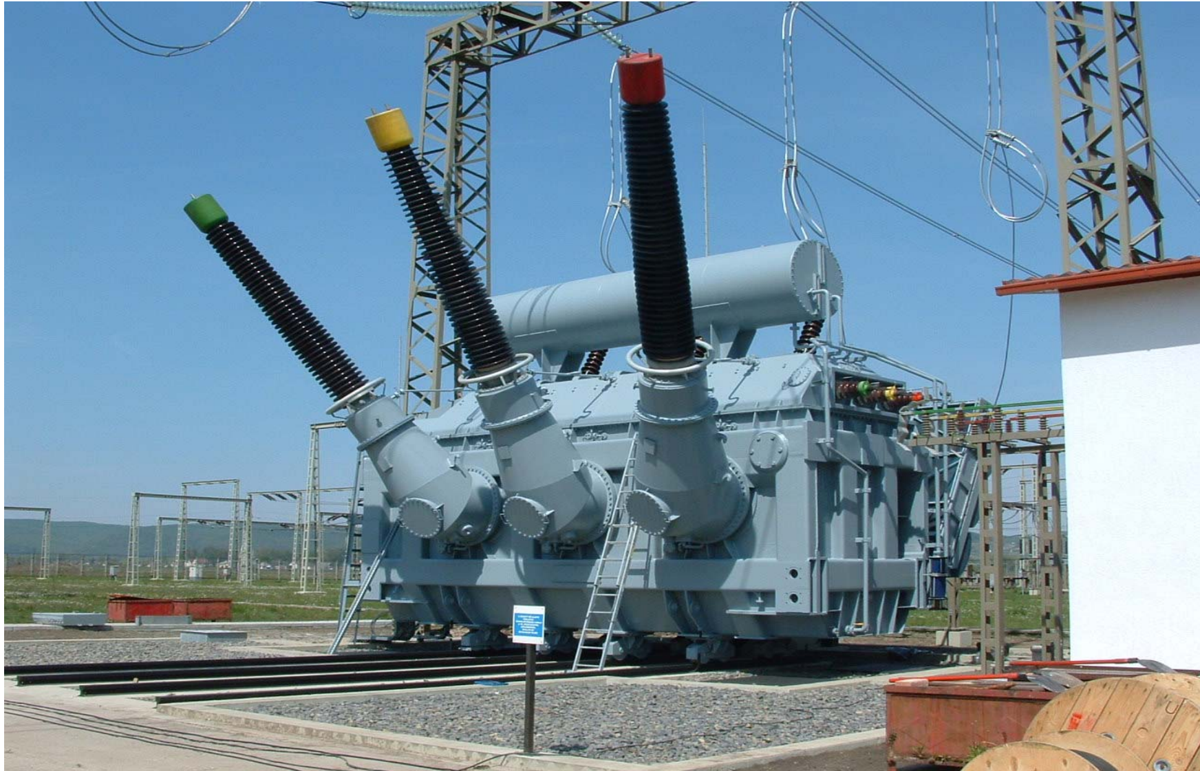
3. sz. trafó helyszíni felújítás és festés után
